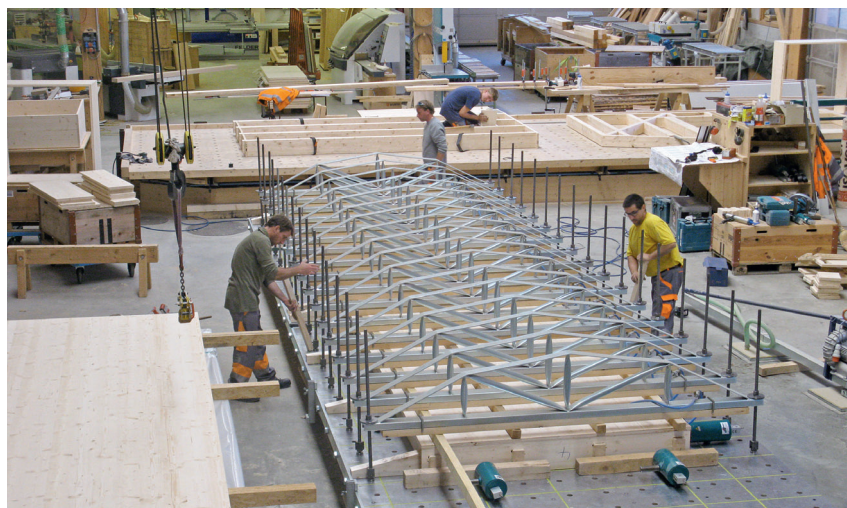
Dank der neuen, pneumatischen Pressvorrichtung produziert man Kastenelemente bei Dénériaz S.A. nun kostengünstiger und mit höherer Qualität.
